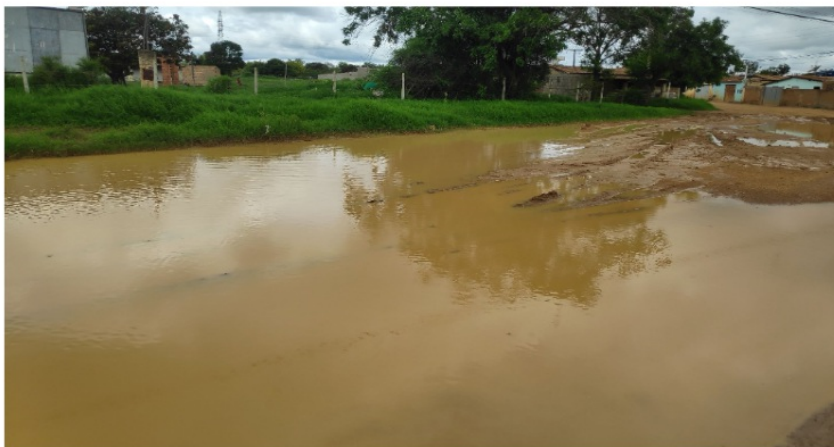
Figura 7: Acúmulo de água na faixa de domínio da rodovia.
